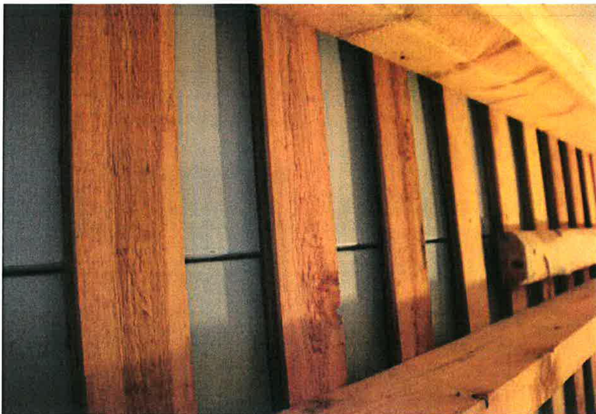
166. Pohjoissiiven ullakon uusinta vesikattorakennetta alapuolelta katsottuna. Muovipinnoitettu rivipelti on asennettu ilman aluskatetta.
