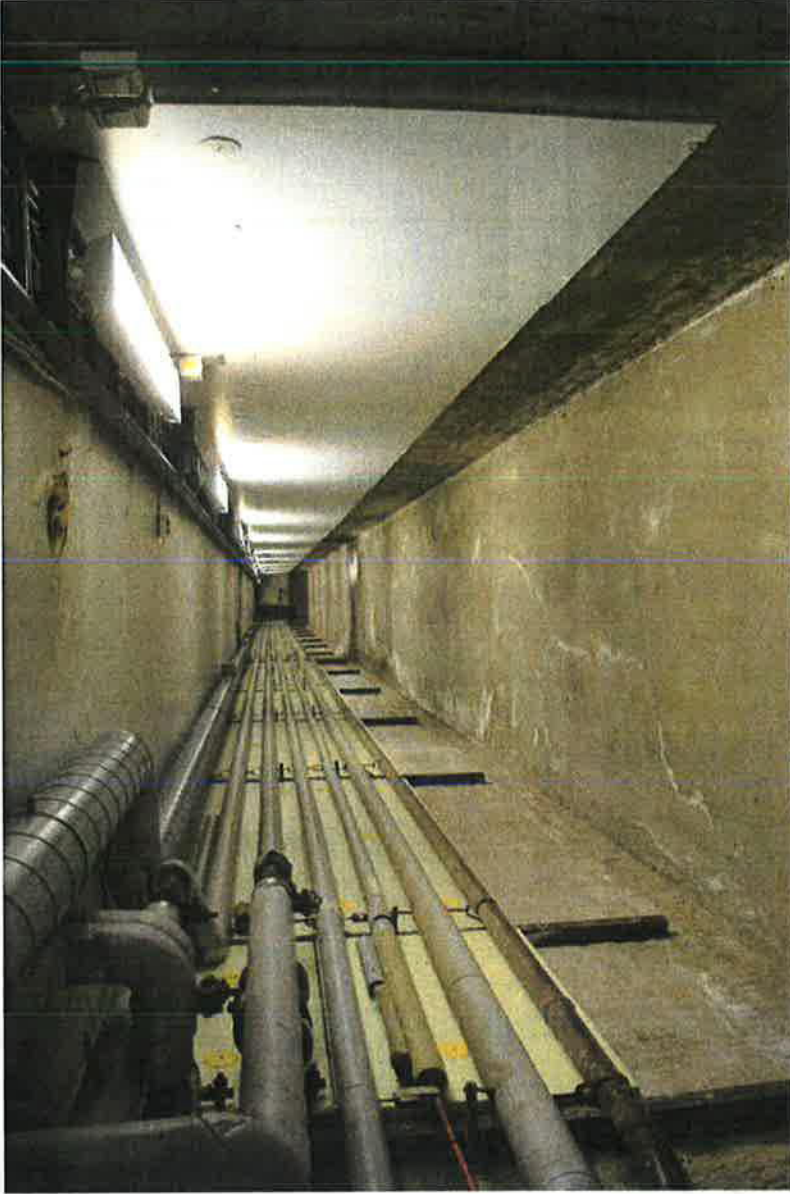
268. Alemman kellarikerroksen kautta kulkee maanalainen tunneli huoltorakennukseen. Tunnelin suulle on myös hissiyhteyks. Tunnelissa kulkee putkitusia ja johdotuksia muun muassa varavolmalaitteille.
