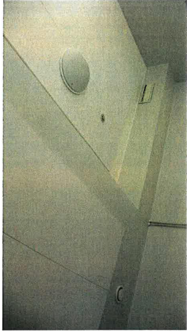
389. Ensimmäisen kerroksen alakattoon on tehty alas lasku ilmanvaihtokanavia varten. Sivuseinällä kanava on koteloitu.
