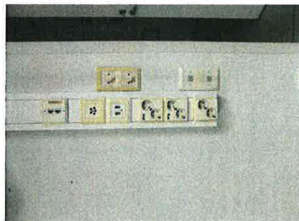
253. Tyypillisiä 1990-luvun sähkökalusteita pystykourussa.
