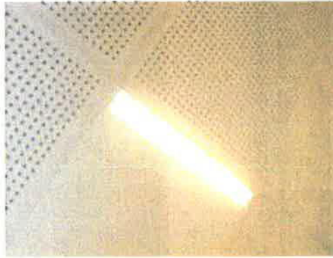
226. Teräksiseen ripustusjärjestelmään kiinnitetty akustoitu kipsilevykatto,
