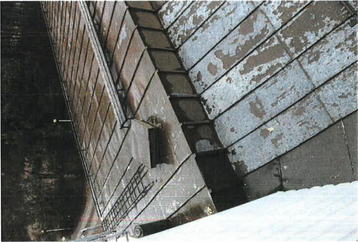
161. C-siiven vesikaton maali on huonossa kunnossa.
