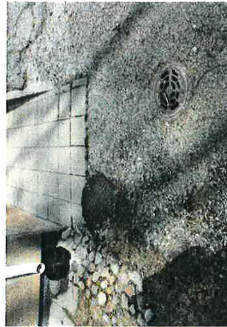
176. A-siiven pihan puolella katolle kertyvä sadevesi johdetaan maanalaiseen hulevesijärjestelmään. Kuvassa näkyvät samassa yhteydessä uusitun salaojajärjestelmän tarkastuskaivo ja hulevesikaivo.
